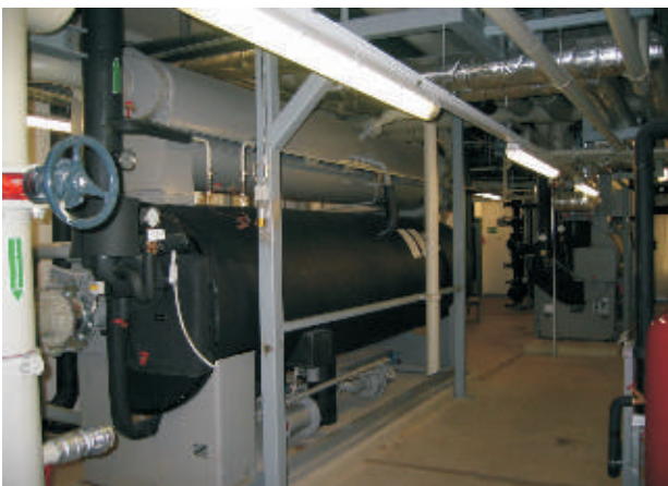
Absorptionskälteanlage (2 x 300 kW Kälteleistung), Neubau Medizin, Universitätsklinikum Erlangen
