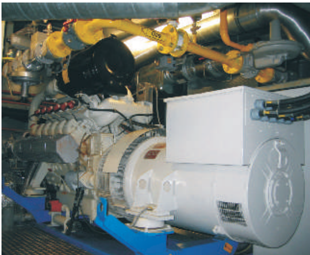
KWK-Anlage (2 BHKW-Module, je 320 \text{ kW}_{el} und je 463 \text{ kW}_{th} ), Neubau Medizin des Universitätsklinikums Erlangen
