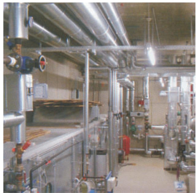
Lüftungszentrale für ein Bürogebäude mit über 5.000 \text{ m}^2 Nutzfläche (Foto: Schulze Darup)
