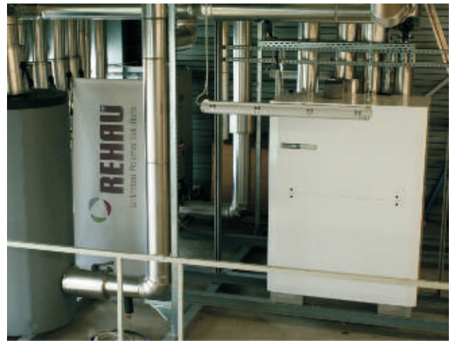
Reversible Wärmepumpe mit 60 \text{ kW} zum Heizen und Kühlen bei der REHAU AG + Co in Erlangen Eltersdorf (Quelle: Fa. REHAU AG + Co)
