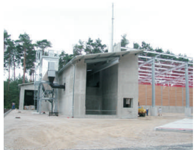
Biomasseheizwerk (rd. 4 \text{ MW} thermisch), Erlangen - Klinikum am Europakanal
